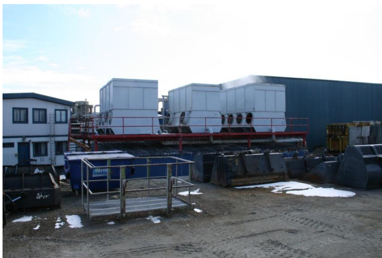
Foto 2: Simrishamns Fryshus, kondensorer.
