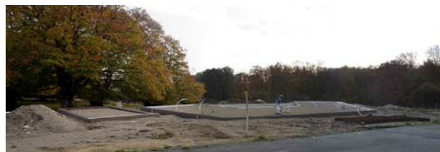
Raskarum 11:92, gjuten grund för garage, påbörjad platta för bostadshus, oktober 2013. Vy från Snickaregatan.
